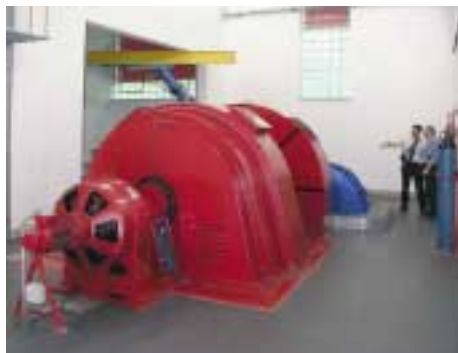
Maschinenraum im Kraftwerk Bargaus mit Generator von 3200 kVA.
