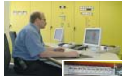
Das Leitsystem Wizcon® in der Zentrale Stenna und die Steuerung SAIA®PCD4 zum Kraftwerk Stenna.
