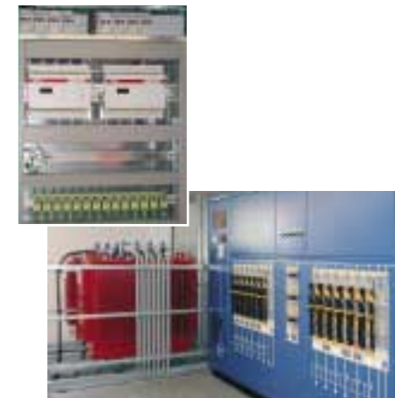
Die SAIA®PCD2 in den Trafostationen kommunizieren via SAIA®S-Bus über Lichtwellenleiter.
