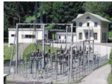
Das Unterwerk Stenna mit Kraftwerk Stenna im Hintergrund.
