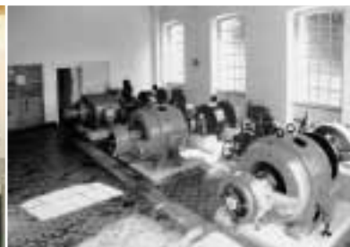
Die alten Maschinen von 1904 mit einer Leistung von 600 kW.
