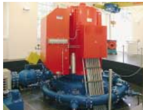
Die moderne 5-düsige Pelton-Turbine mit Generator von 2100 kVA im KW Stenna.
