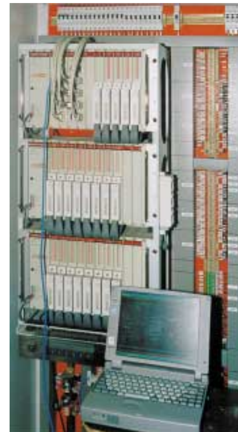
Inbetriebnahme der Programme mit einem Notebook via Master-PCD6. Gut sichtbar sind die 11 Kommunikationsverbindungen zu den Slave-PCD6 und den Terminals, ausgehend von den drei Prozessormodulen im Hauptgehäuse oben. Gleich darunter befinden sich die beiden Erweiterungsgehäusen für die zusätzlichen E/A-Module.
