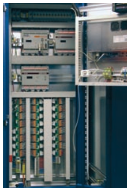
Schaltschrank in der Tunnelzentrale Birchi Ost mit Saia®PCD und in die Tür eingebauter Touchpanel-PC. Alle E/As sind über Flachband-Systemkabel sauber auf die Schraubklemmen-Adapter geführt
