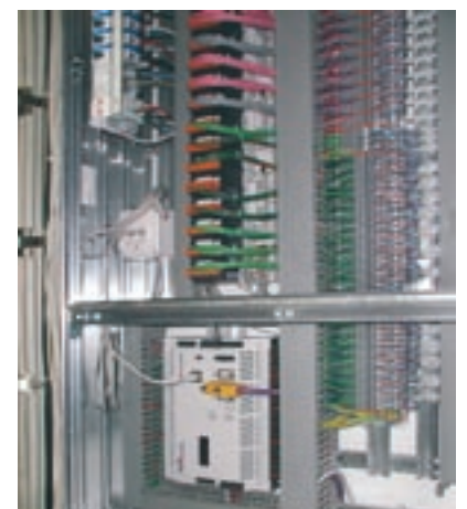
Unterstation Saia®PCD2.M480 mit E/A-Erweiterung PCD3.LI0 im schmalen Schaltschrank mitten im Büro
