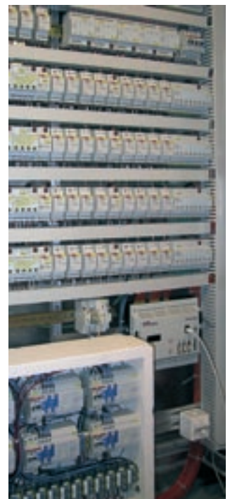
Schaltschrank für die Lichtregelung. Von der Saia®PCD2 geht eine Verbindung zur Ethernet-Steckdose, die andere zu den vielseitigen EIB-Bausteinen.
