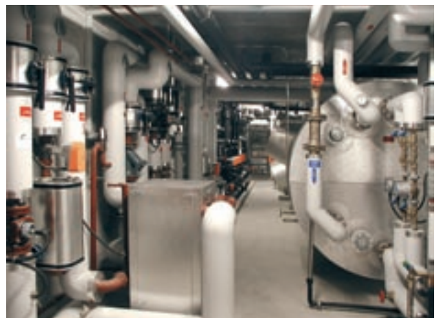
Warmwasserverteilung im Untergeschoss mit Belimo®-Stellantrieben
