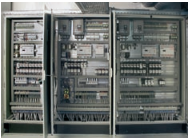
Schaltschränke mit den Unterstationen Saia®PCD2.M120 plus Erweiterungsgehäusen
