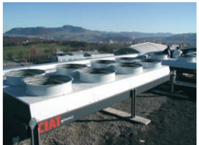
Kühlgeräte auf dem Hoteldach
