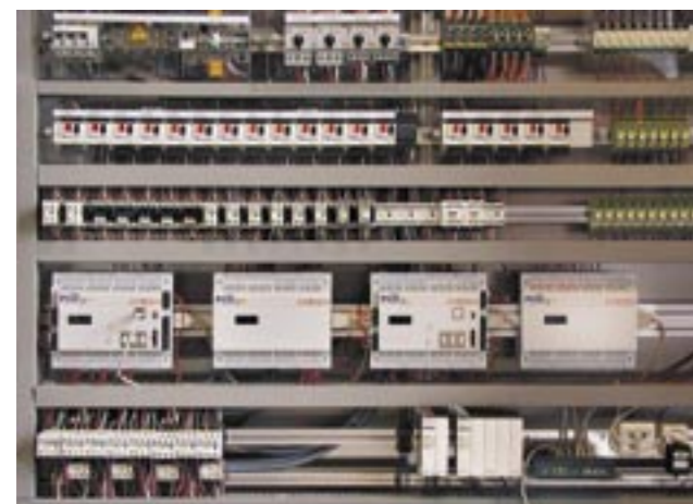
Schaltschrank HLK-A mit zwei Saia® PCD2.M170 mit Erweiterungsgehäusen für HLK-Steuerung der Verkaufsläden im Erdgeschoss und im ersten Untergeschoss
