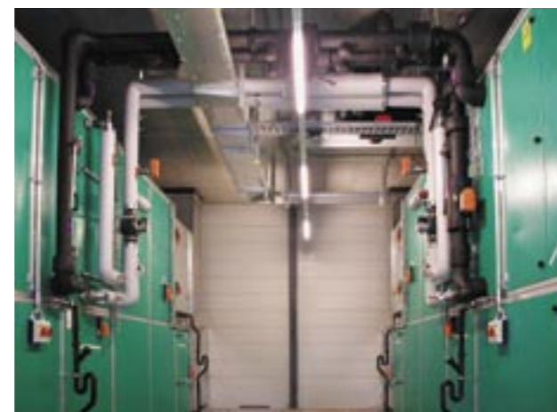
Heizregister mit den orangefarbenen Stellantrieben von Belimo®
