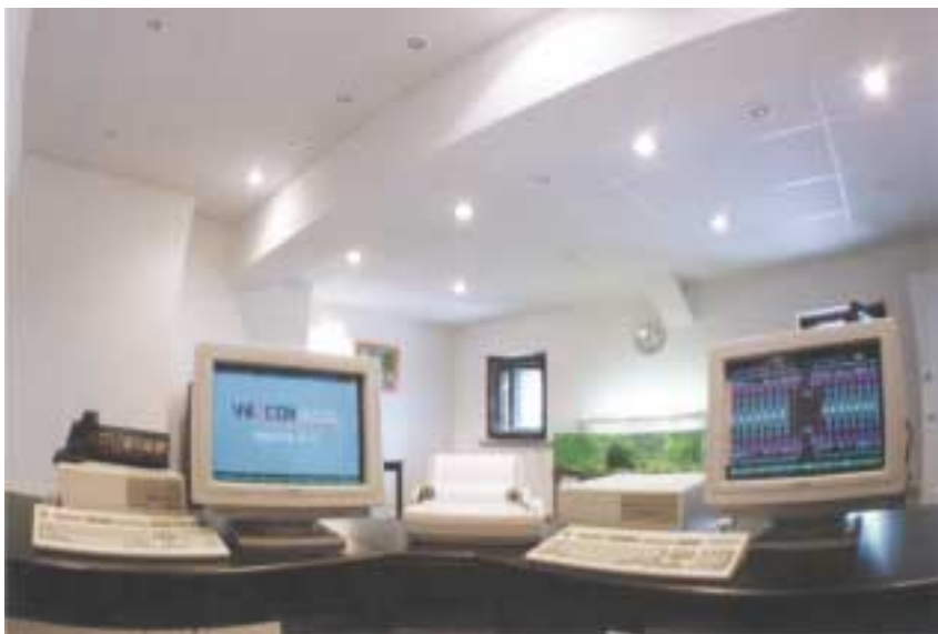
Zentrale Leitstelle mit den zwei unabhängigen WIZCON-Systemen.
