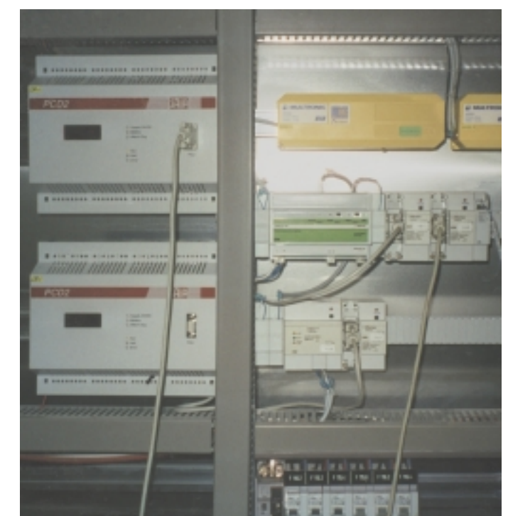
Schalttschrank mit zwei Steuerungseinheiten SAIA®PCD2 in Kombination mit EIB-Komponenten
