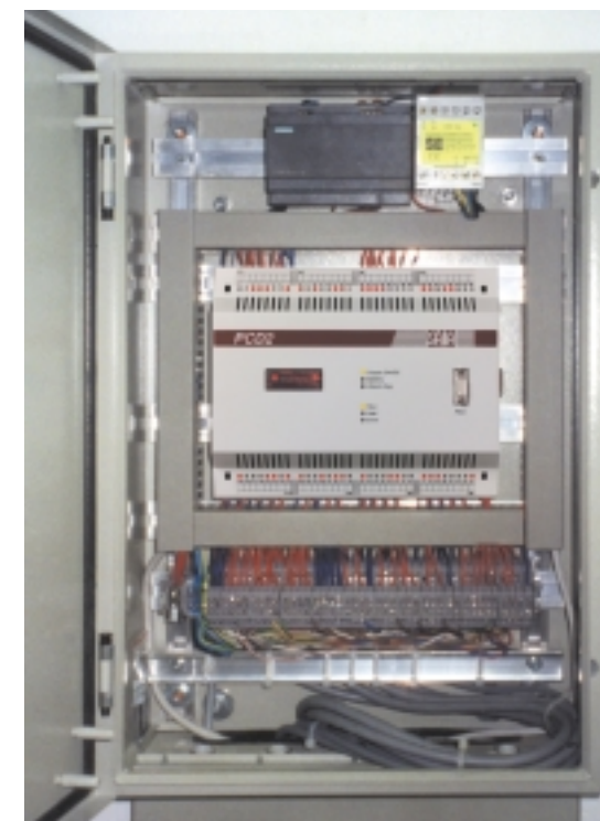
Der Schaltschrank mit der intelligenten Wetterstation SAIA®PCD2, eingebunden im LON-Netzwerk
